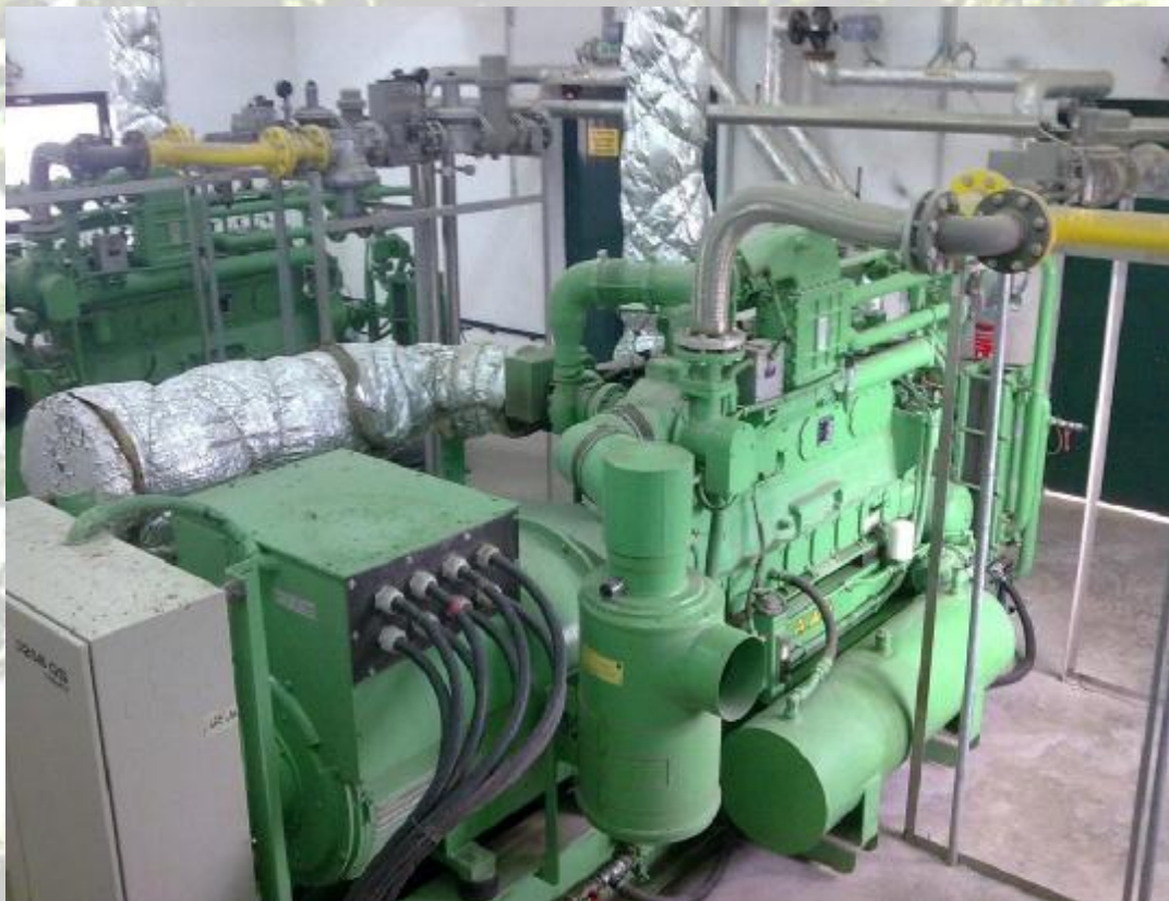
Εικόνα 6.: Εγκατάσταση παραγωγής ηλεκτρικής ενέργειας.
